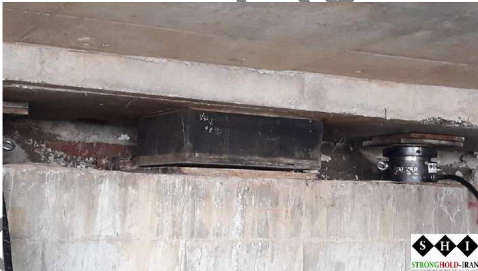
شکل ۱۲- جدا شدن بالشتک از پایه‌ی پل
