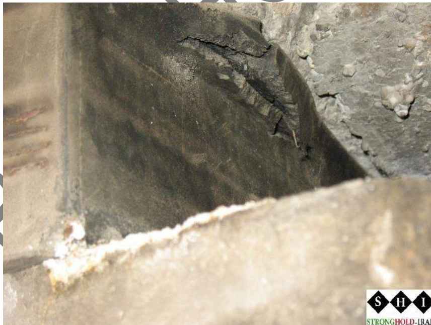
شکل ۸- خرابی لاستیک بدلیل استفاده از جنس نامرغوب
