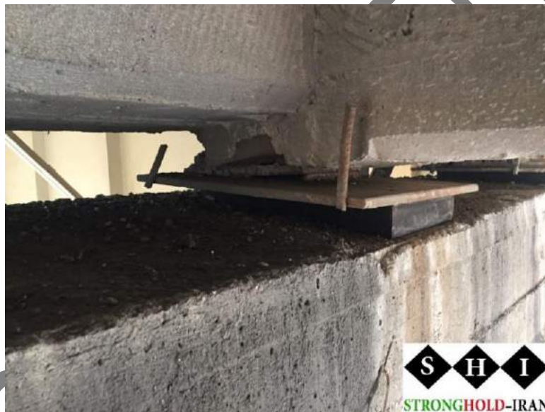
شکل ۴- خرابی تکیه‌گاه الاستومری به دلیل عدم زیرسازی مناسب و عدم استفاده از لایه گروت
